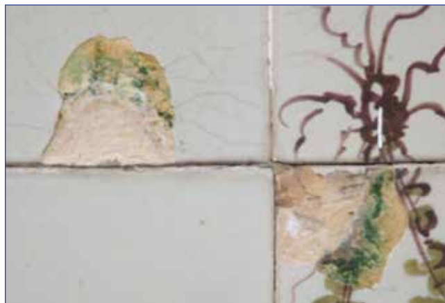
Destacamento de vidrado provocado por colonização biológica
