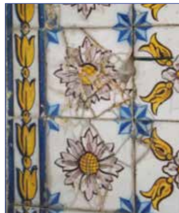
Fissura e fraturas
