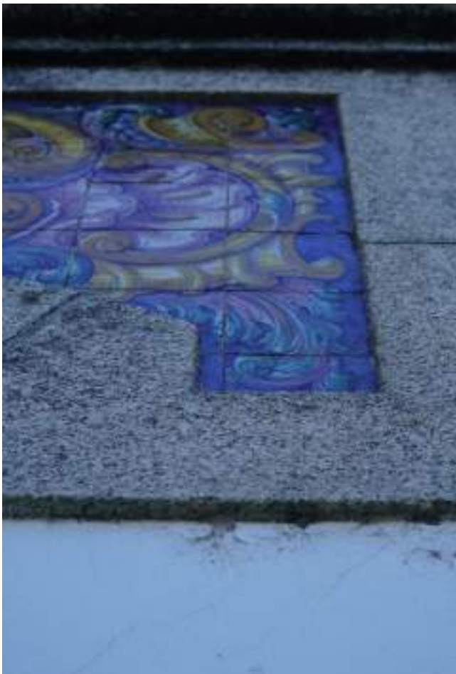
Fachada lateral direita: (destruído na sua quase totalidade)
