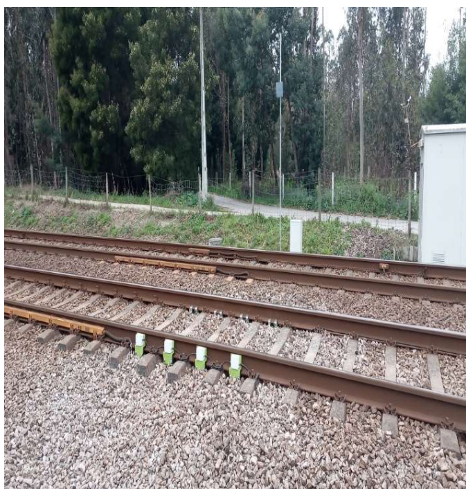
Instalação do Sensor TNE - Track Node Electronics
