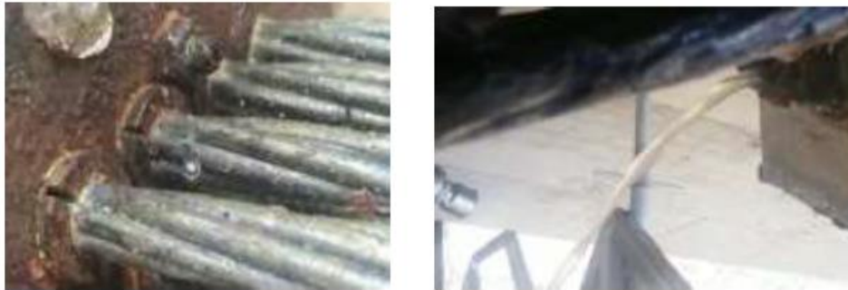
Figura 12. Anomalias nas ancoragens inferiores
