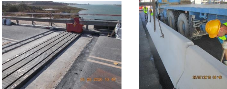
Figura 20. Trabalhos de substituição das juntas de dilatação e colocação de barreiras de segurança
