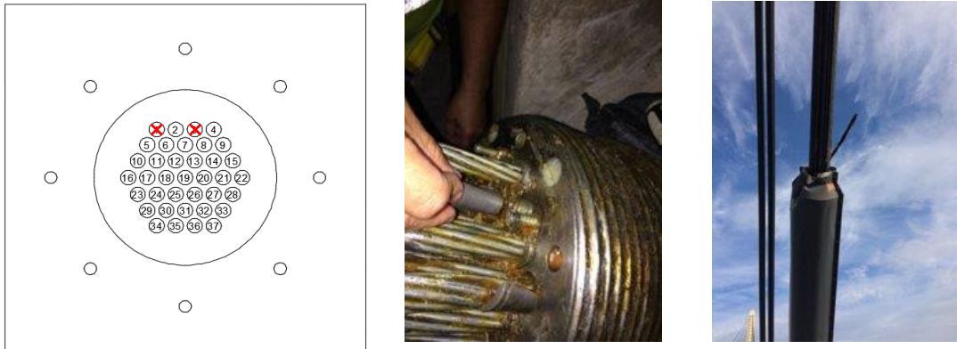
Figura 7. Pormenores da rotura do 2º cordão do tirante 3-29-S
