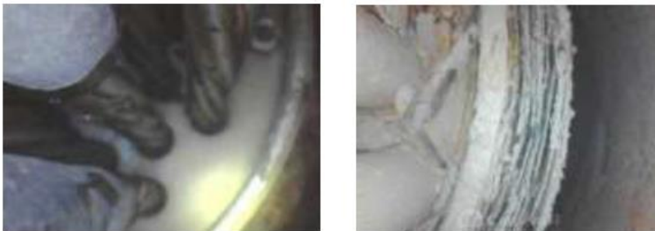
Figura 10. Anomalias na proteção de cordões e delaminação na prensa estopa
