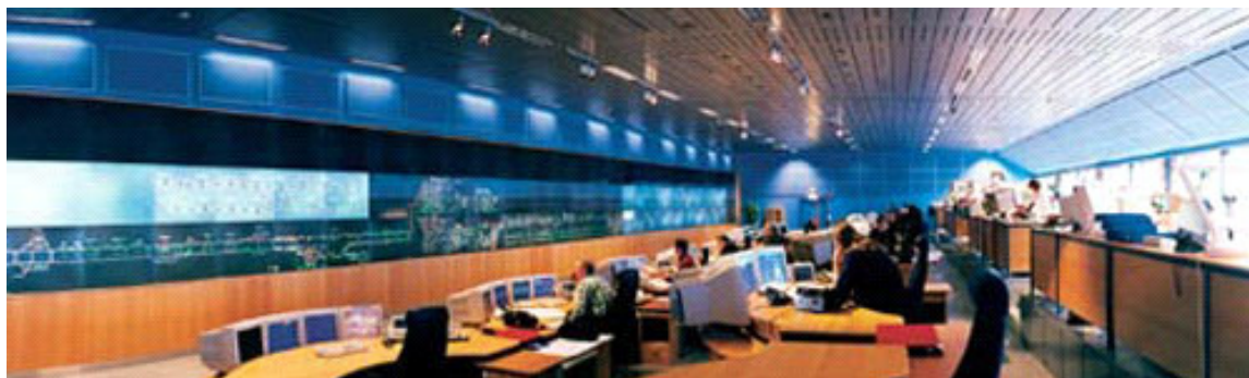
Figura 4.5. – CTC-Sala de Controlo
