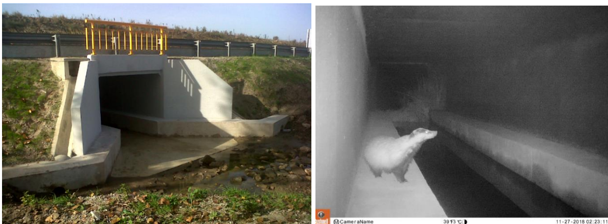
Fig. 33 – PH na EN18, ao km 274,800, com dois passadiços secos. Na fotografia da direita é possível visualizar um texugo a utilizar um dos passadiços (fotografia captada pela Universidade de Évora durante a monitorização da PH).
